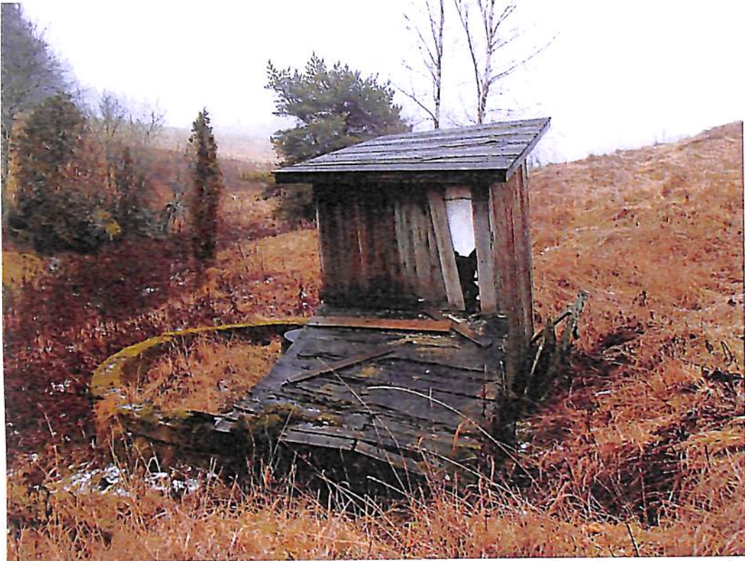
Kuva 3. Kulttuurimaisemassa vielä näkyviä, mutta parhaillaan katoamassa olevia rakenteita ovat muun muassa pumppuhuoneet, joita harvakseltaan löytyy Aurajoen varresta. Nämä rakennukset suojasivat nimensä mukaisesti pumppuja, joilla karjanhoitoon käytetty talousvesi nostettiin joista. Kuva: Nautelankosken museon kokoelmat, NKM/va/11243:7970.
